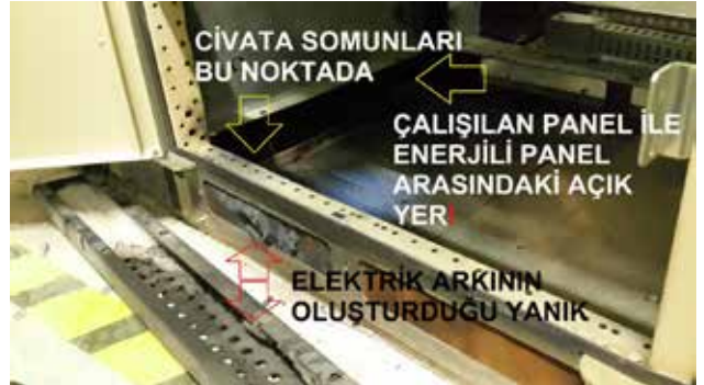
Fotoğraf 12 – Elektrik ark flaş patlaması sonucu oluşan yangının hasarı
