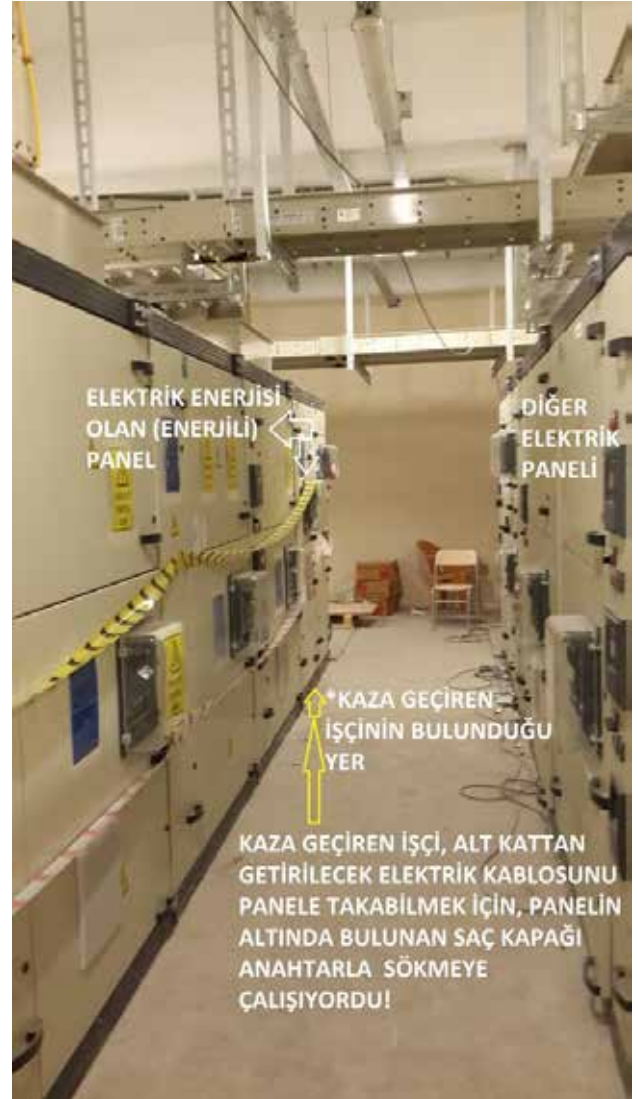
Fotoğraf 5 – A. Aydın'ın çalıştığı; kurulma işleminden sonra enerji verilen (LV- Alçak Gerilim) elektrik kontrol odası
