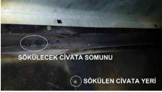
Fotoğraf 9 – Enerjili panelin yanındaki panelde sökülen civatalar
