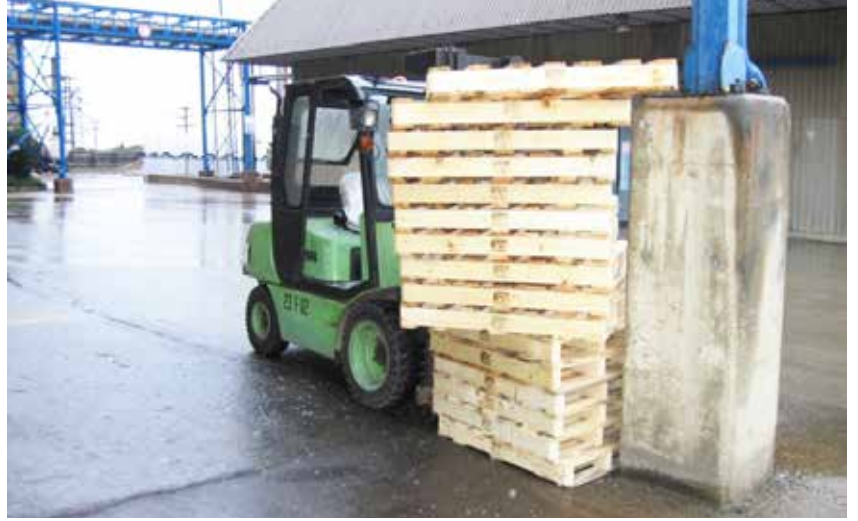
Resim 6 - Forklift operatörünün çarptığı kolon / direk.
